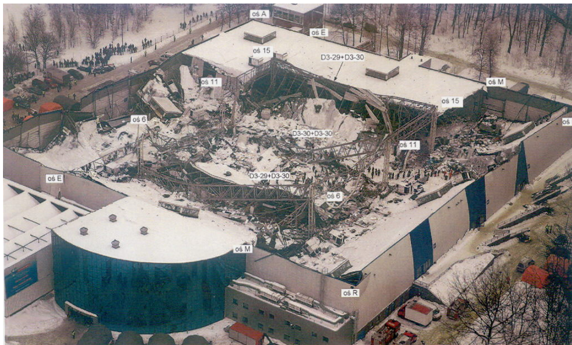
Rys. 2. Widok pawilonu wystawienniczego na terenie Międzynarodowych Targów Katowickich - po katastrofie
